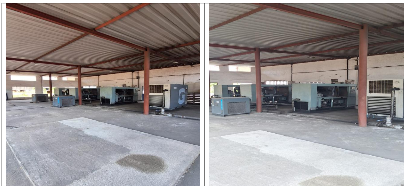
CONJUNTO DE 4 COMPRESSORES ATLAS COPCO
